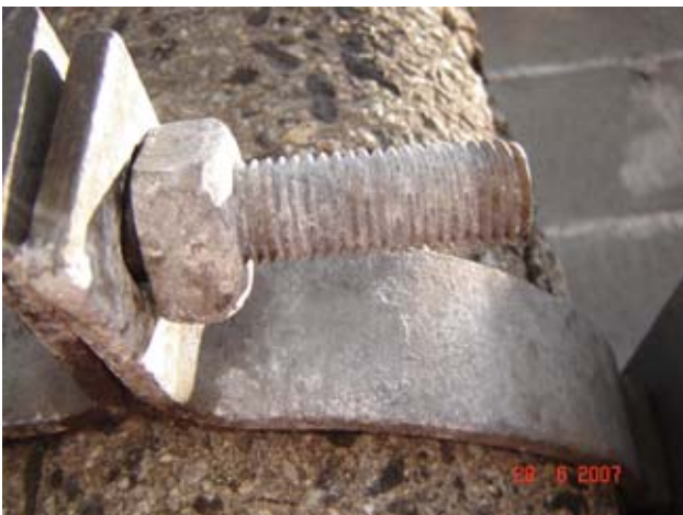
Parafuso não protegido com CorrosionX
