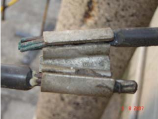
Conector não protegido com CorrosionX
