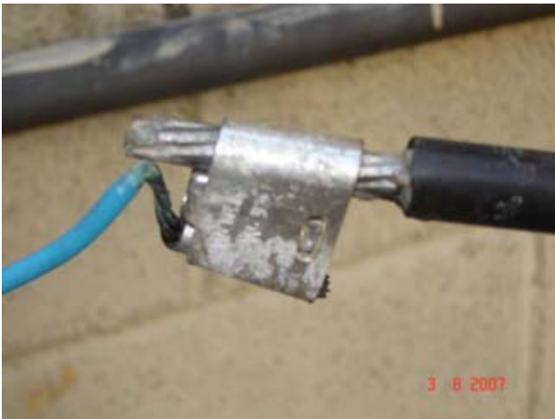
Conector não protegido com CorrosionX
